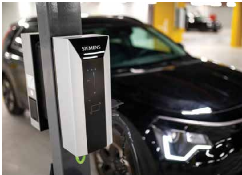
200 carregadores para veículos elétricos e um sistema de gestão inteligente da infraestrutura de carregamento instalados no edifício Infinity
